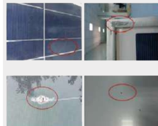
Resim 3-Camda çizik - Çerçeve hasarı - Camda çatlak - Backsheet üzerinde hasar
